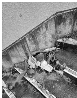
野球場の破損箇所
