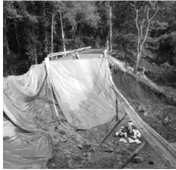
真木平線の災害現場
