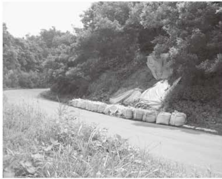
仮復旧状態の大館十和田湖線（樹海ライン）
