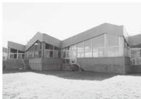
雨漏りなど傷みが進む旧十和田小中学校
