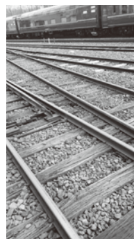
交換が必要な枕木
